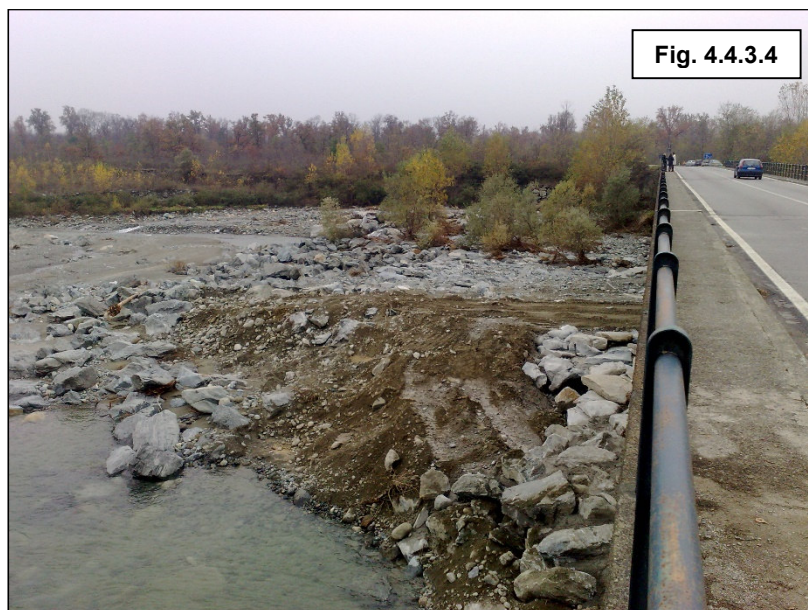
La soglia a valle del ponte è stata completamente smantellata (12/11/2011, vista verso valle)
